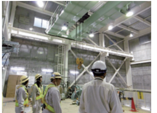
▲発電所建屋内
