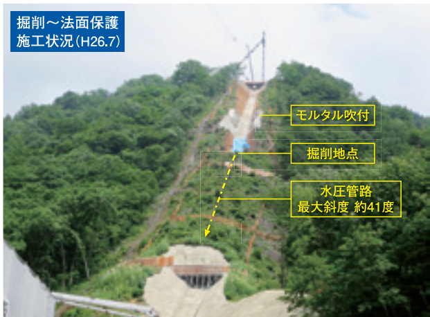
▲水圧管路(中間部)
