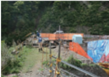
▲オレンジネットによる昇降設備・墜落防止設備の見える化
