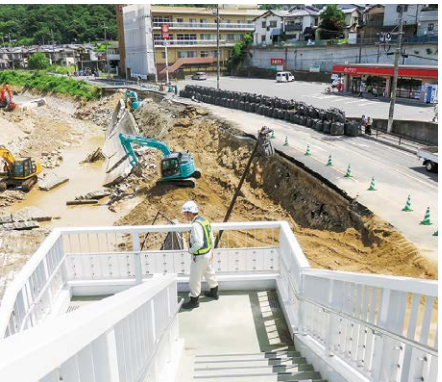
被災現場確認
