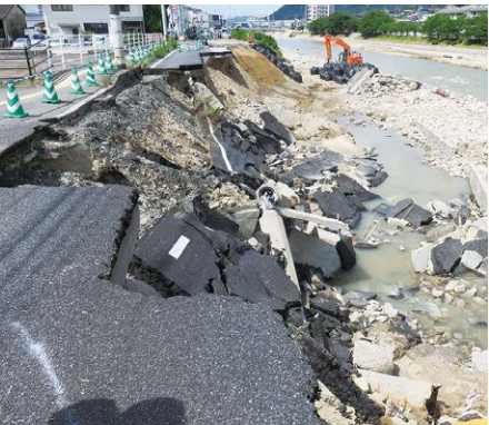
被災現場確認
