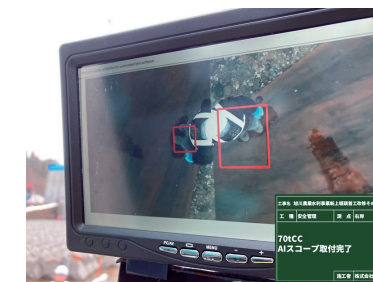
吊荷監視カメラ用モニター
