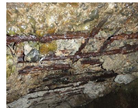
写真5 床版下面劣化状況
